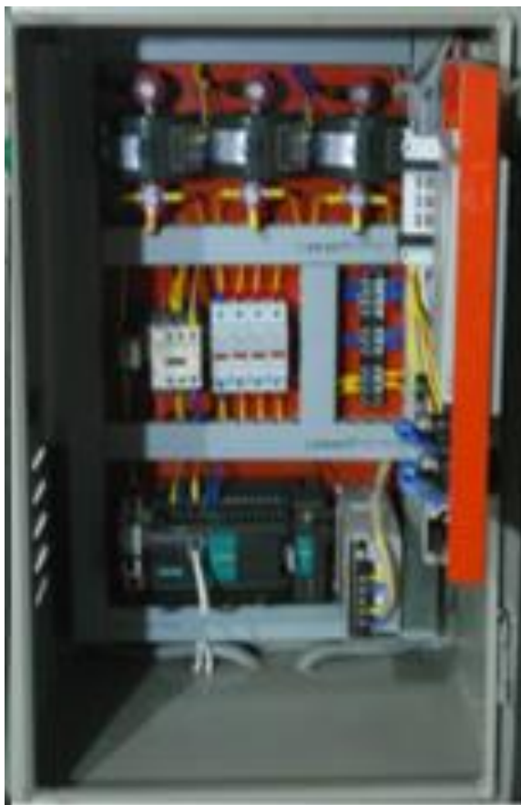
Hình 6. Tủ điện chứa các thiết bị của hệ thống nghiên cứu.
