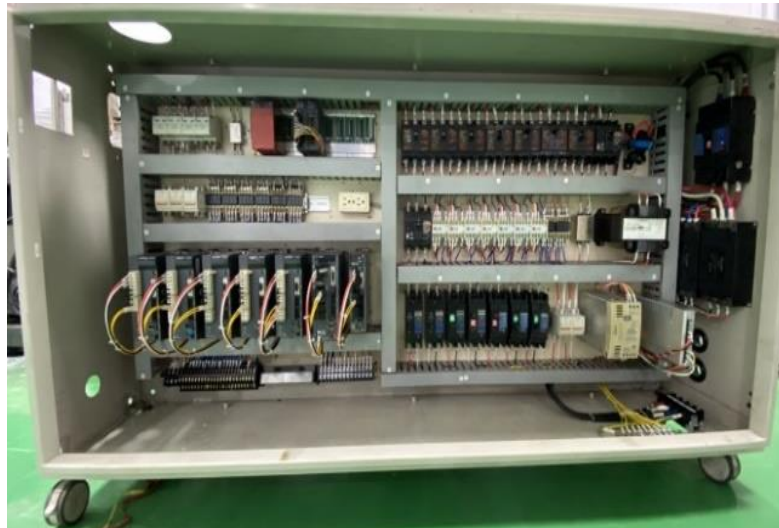
Hình 13. Tủ điện điều khiển máy
