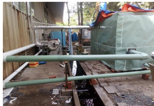
Hình 6. Hệ thống bồn tích trữ lạnh sau khi được chế tạo và lắp đặt.
