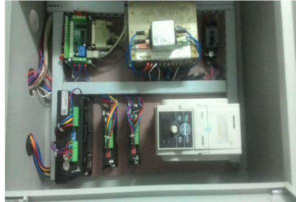
Hình 8. Tủ điện điều khiển.
