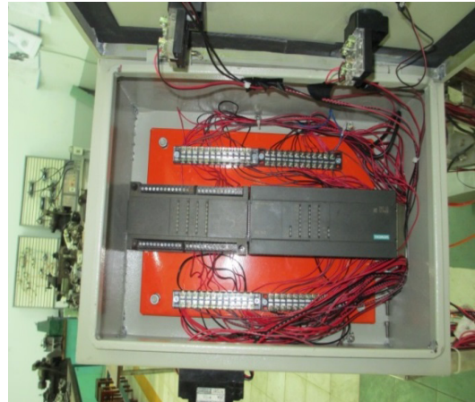
Hình 16: Tủ điện điều khiển.
