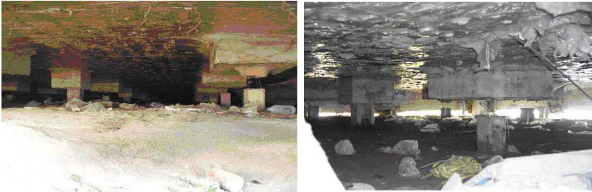
Hình 4: Sự cố cọc bị bứt ra khỏi đài dưới tác động của ma sát âm. ([3])
